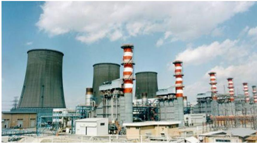
تصویری از یک نیروگاه چرخه ترکیبی
